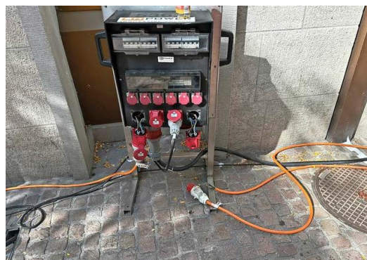
In der Nacht auf Sonntag wurden diverse Stromkästen und Kabel auf dem «Stars in Town»-Gelände beschädigt. BILD: Z/VG
